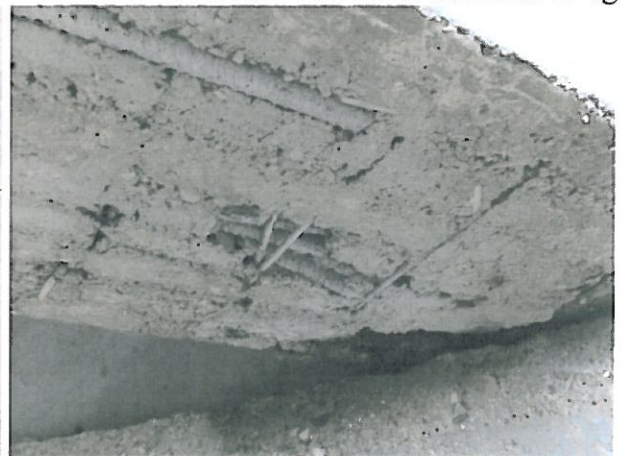
Foto 25 – Beton segragat in grinda
