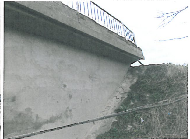
Foto 23 – Zid intors aval mal stang
